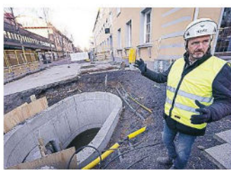
Här har man anlagt en sänkbrunn där den nya dagvattenledningen ska anslutas till den gamla.
