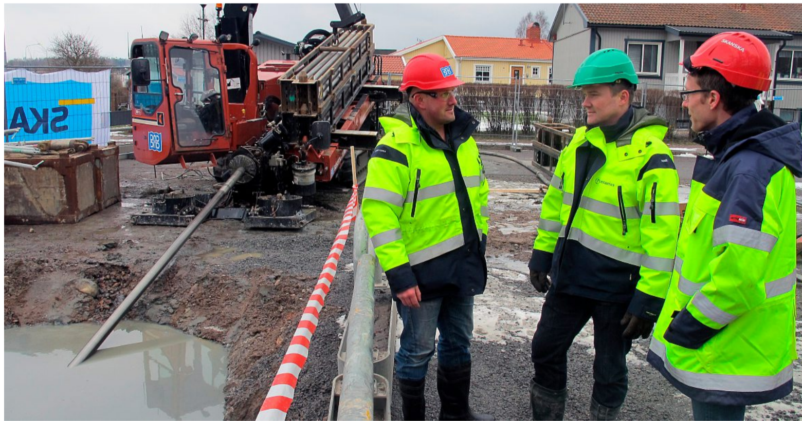
Borrning. Den långa borren arbetar sig under både Storån och kanalen och kommer upp vid Ramunderbergets fot. Magnus Tingstrand BAB Rörtryckning, Natanael Ljung, Pontarius och Rickard Bardun, Serviceförvaltningen.
